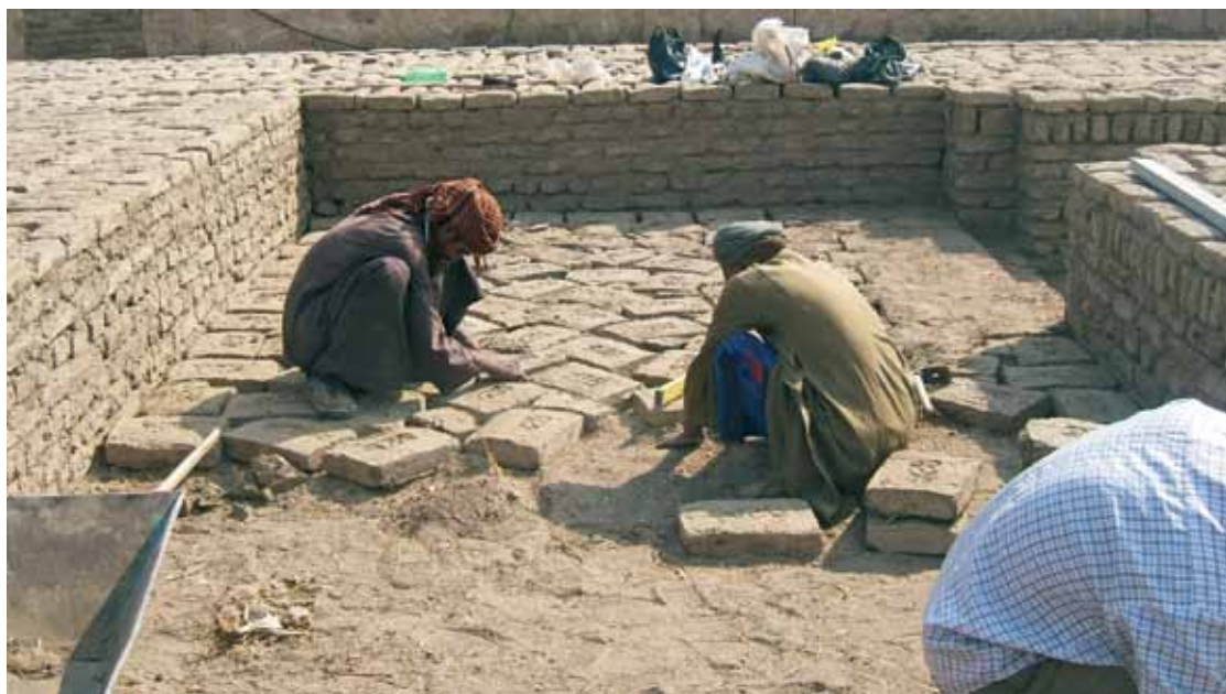
A.- Ramesseum. Pose de pavés en terre crue dans l'une des chambres-annexes (PLR.SA10) de la «salle du trône» du palais royal. [Cliché © Christian Leblanc-MAFTO/ASR].
