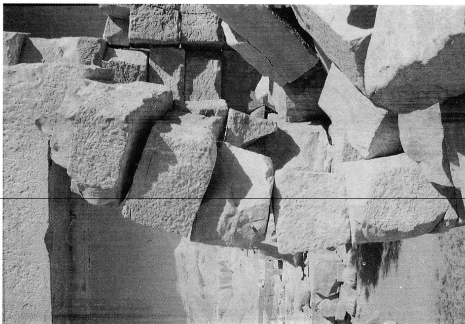
2. - Vue montrant l'ampleur du bombement du montant nord de la porte. La surface de contact entre les blocs est minime. (Cliché Jean-Claude Golvin).
